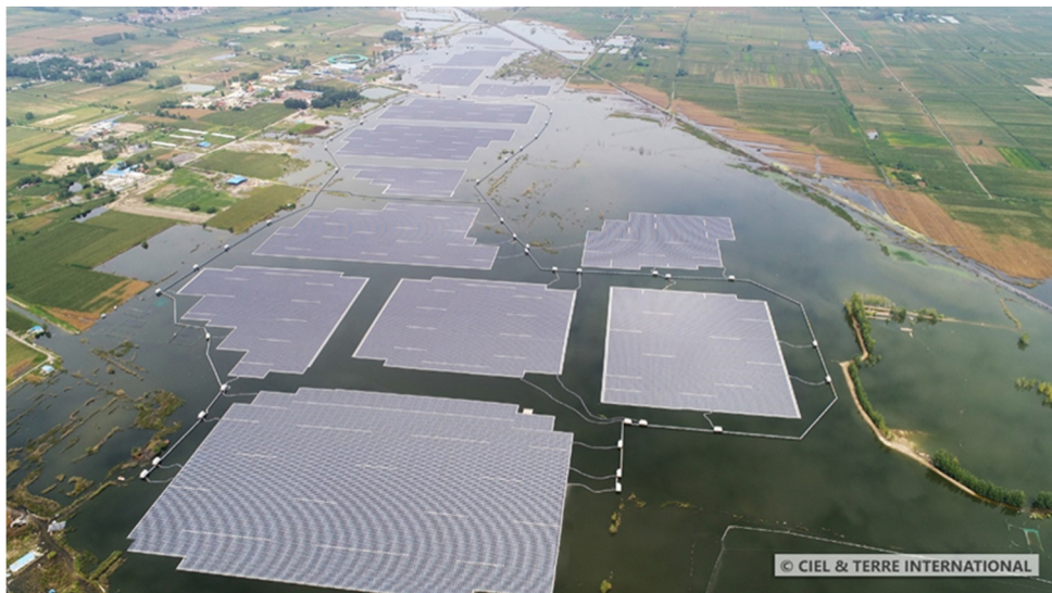
6.1 pav. 70 MWp plūduriuojanti saulės elektrinė Kinijos Anhui provincijoje, karjero tvenkinyje [6]
